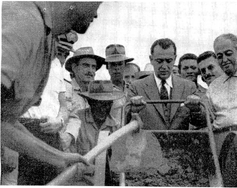
● S. Exa. faz questão de despejar, êle mesmo, uma carrada de concreto...
